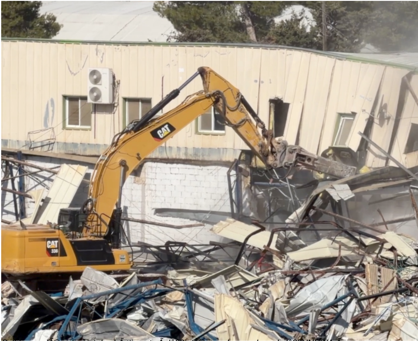
Bulldozers d'abolissant des btiments  l'intrieur du complexe de l'UNRWA  Jrusalem-Est  Janvier 2026 Photo UNRWA.
