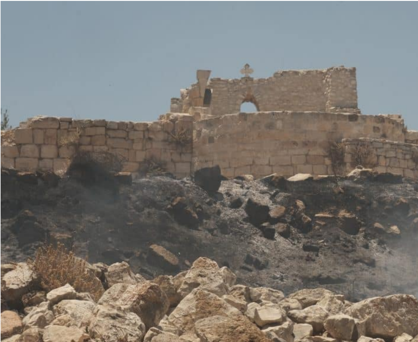
Conséquences d'un incendie criminel perpétré par un colon israélien près de l'église Al-Khader dans le village palestinien de Taybeh, au nord-est de Ramallah, le 7 juillet 2025. (Photo : Qassam Muaddi/Mondoweiss)
